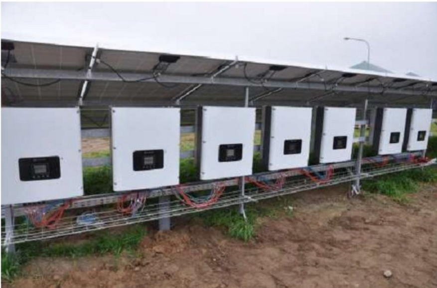
Abbildung 2 Wechselrichter unterhalb der Modultische angebracht
